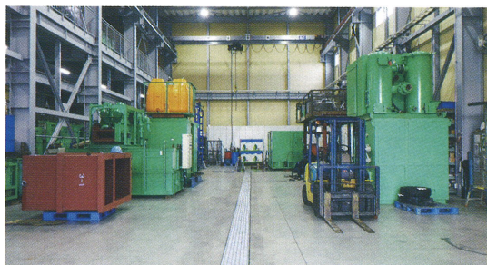
写真-3 A棟吹抜け部 送泥プラント他 左柱上が2F
